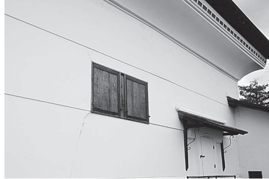
3月の地震でひび割れが生じたふるさと資料館
