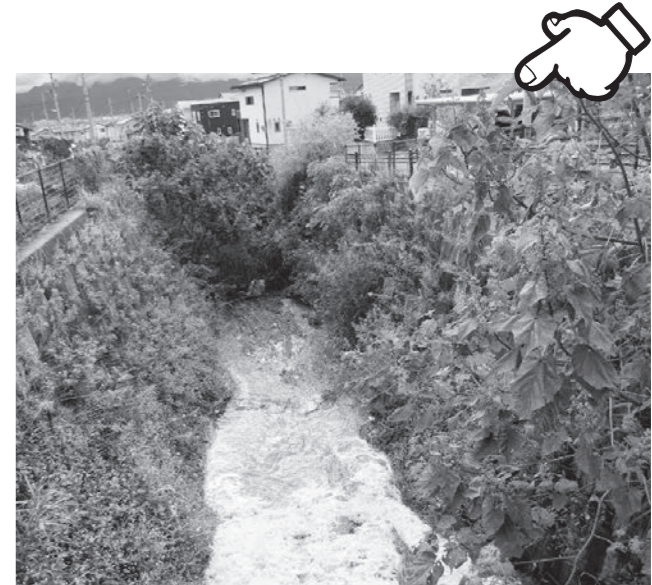
緑ヶ丘地内の水路に繁茂した草木
