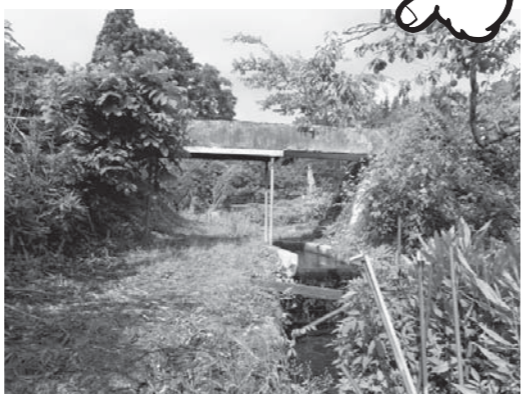
老朽化し、鉄柱で補強されている運台寺地内の水路橋
