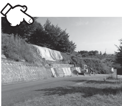
刈り払い草や枝が詰まった狭い水路が越水し法面崩壊、緊急復旧工事が施工された諏訪山登り口
