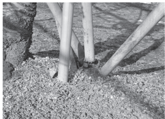
経年劣化で腐食し、補強を要するパイプ支柱の根本付近
