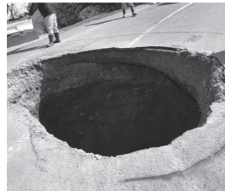
町道中作谷沢線の陥没箇所
