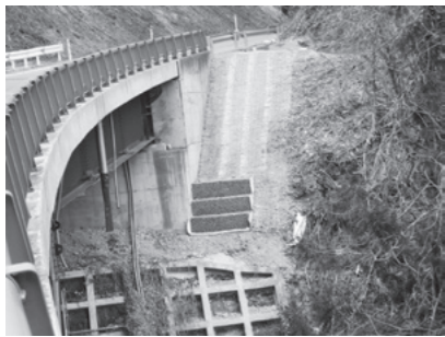
7月豪雨災害による復旧箇所 (町道築沢玉虫線)
