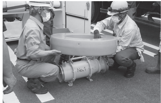
町取得の排水ポンプ
